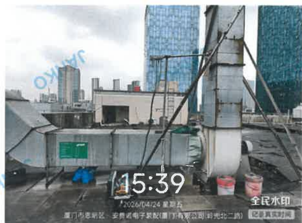
C 栋楼顶排气筒 (焊锡) 15
