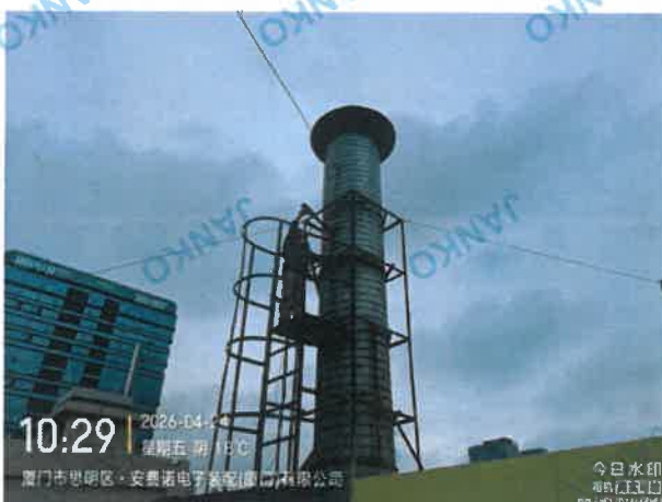
B 栋顶楼排气筒 (注塑) 04
