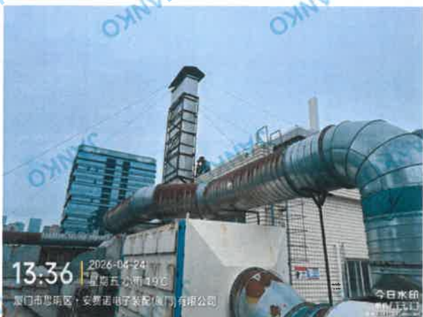
A 栋顶楼排气筒 (焊锡、注塑) 01
