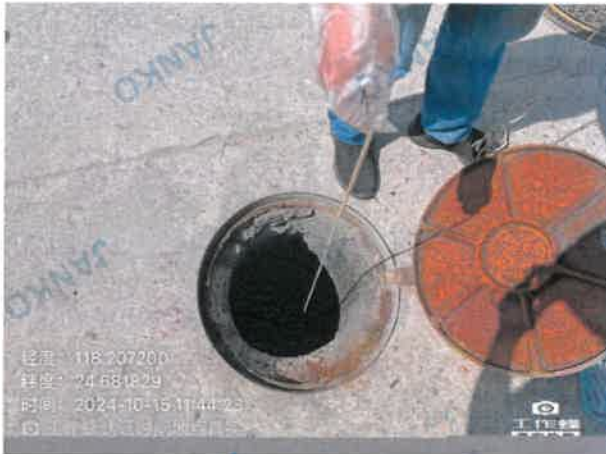
生活污水排放口 01
