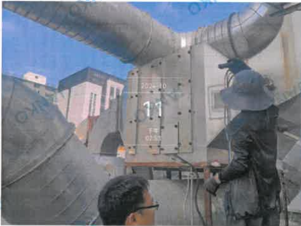
A 栋顶楼排气筒（焊锡）01
