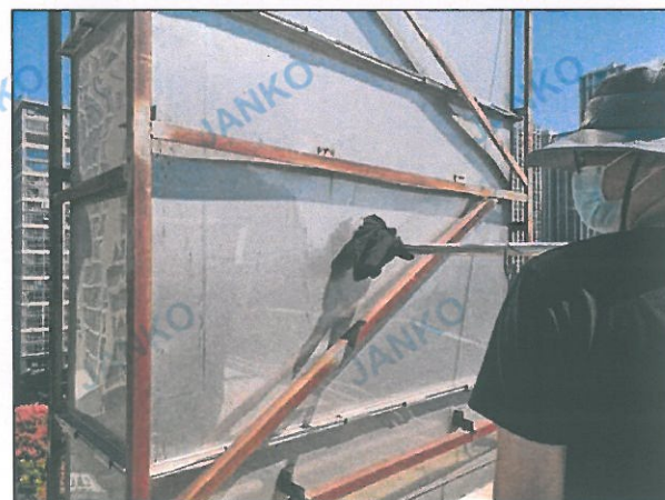
A 栋顶楼排气筒(焊锡) 01
